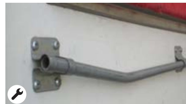
Capitons et tringles: tringles et capitons déformés dans la limite économique de la réparation
