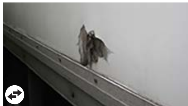
Panneaux latéraux bois: support bois endommagé \geq 20cm
