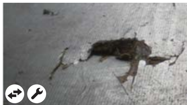
Déformations ou perforations hors limite économique de la réparation. Possibilité d'échange du plancher par tronçon
