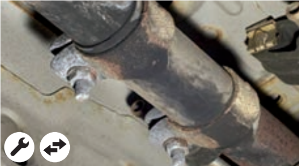
Présence de fuites Rouille
