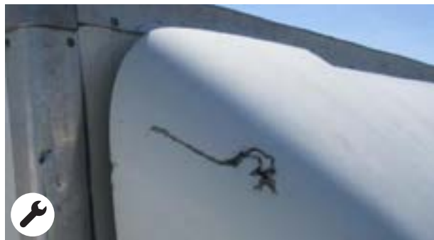
Capucine et déflecteur: dans la limite économique de la réparation
