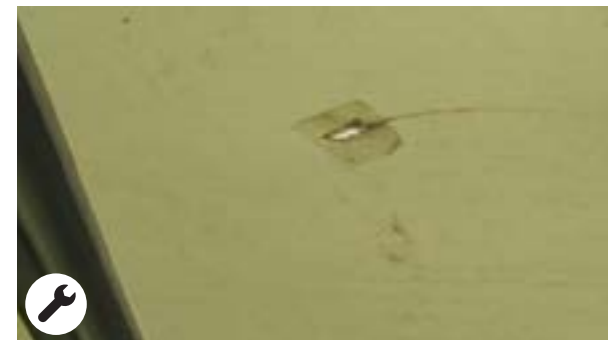
Pavillon: perforé ou déchiré dans la limite économique de la réparation
