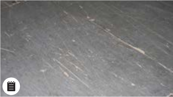
Plancher: déformations légères, usure superficielle
